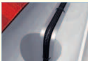
Kantenschutz am Übergang von Dachrinne ins Fallrohr.
